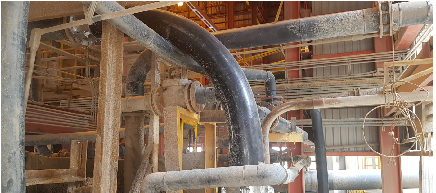
Instalación de prueba para transporte de arena sílica.
