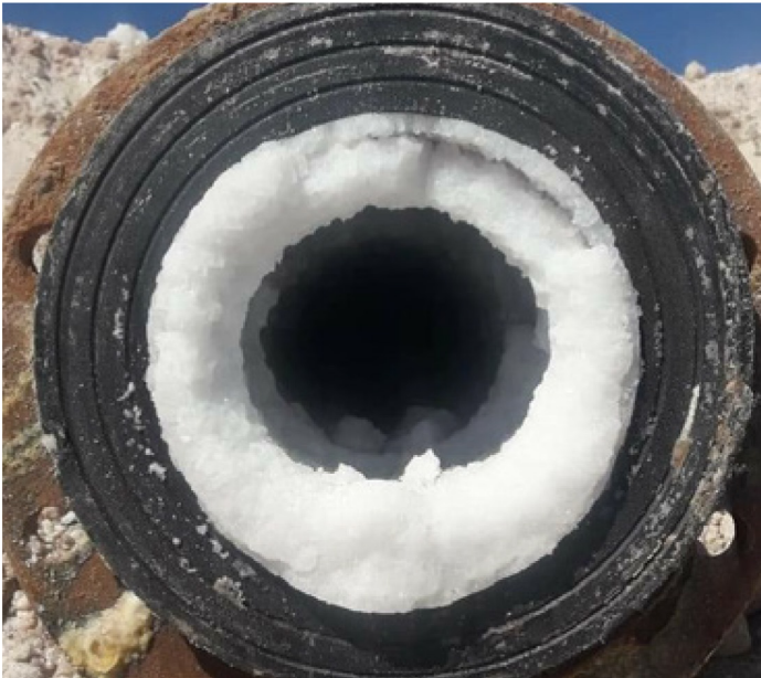
Сравнение отложения осадка: труба из ПЭВП после 30 дней использования.
