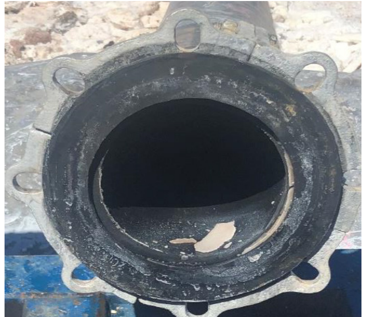
Comparación de sedimentación: Tubería Pexgol luego de 60 días de uso.
