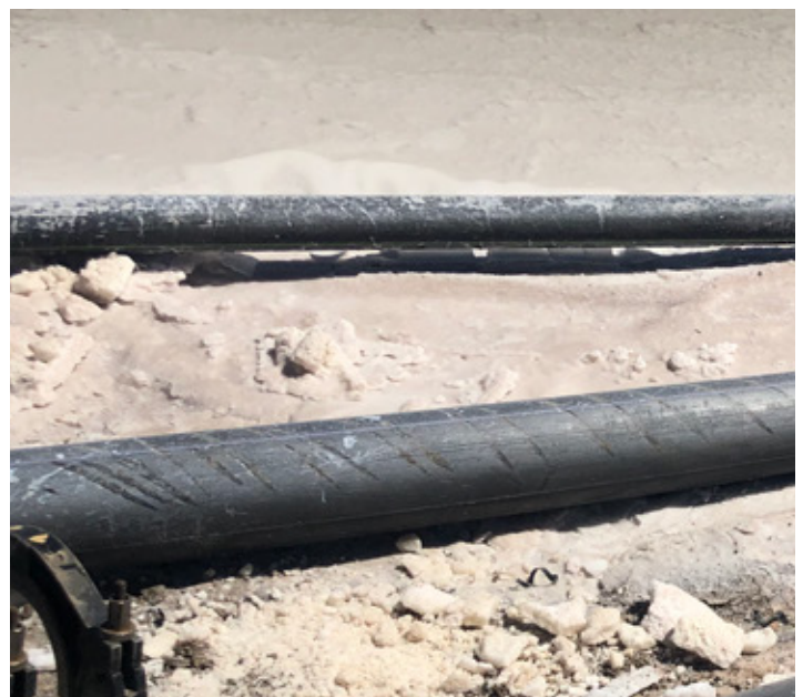
La limpieza de las tuberías de HDPE es un gran desgaste físico para los operadores, ya que deben ser fuertemente golpeadas para aflojar las incrustaciones, que implica mayor cantidad de horas invertidas en mantenimiento.
