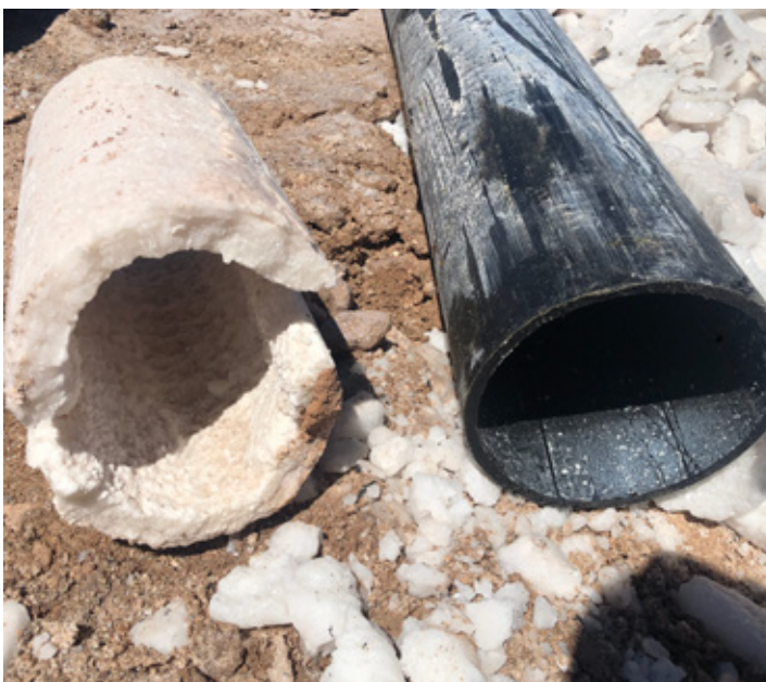
Luego de 30 días de operación la tubería de HDPE presenta incrustaciones con un espesor aproximado de 50 mm.
