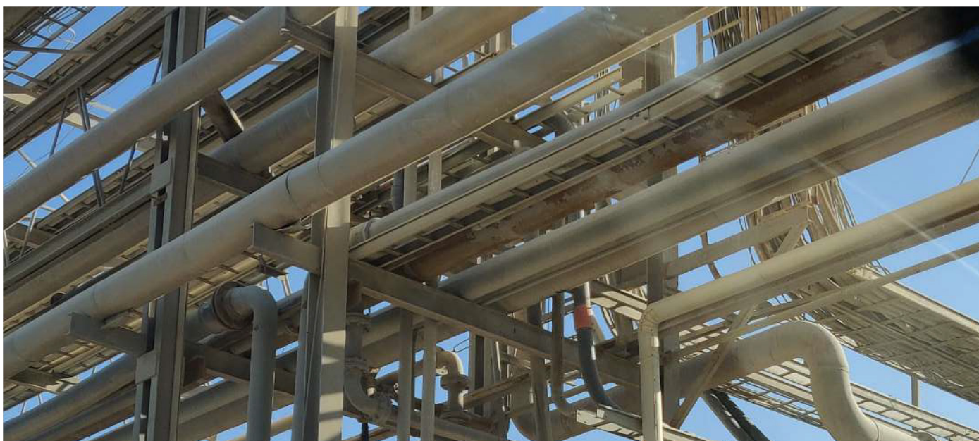
Трубы Pexgol для транспортировки фторкремниевой кислоты.
