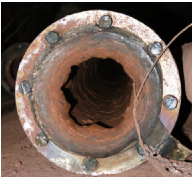
Tubería de acero al carbono
