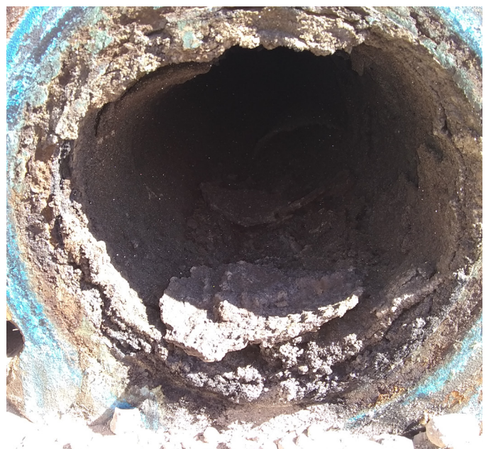
Tubería de acero al carbono incrustada
