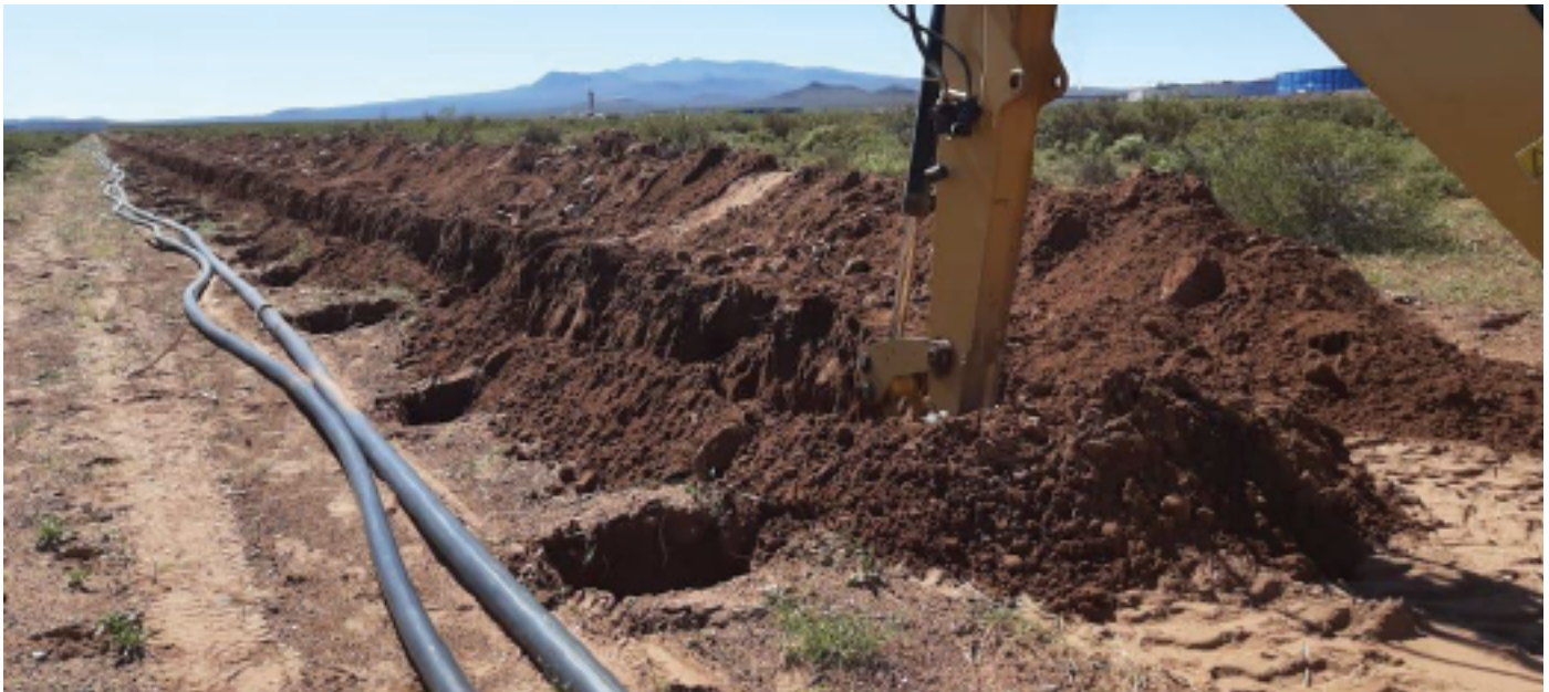
Línea de gas seco combustible para accionamiento de bombas.
