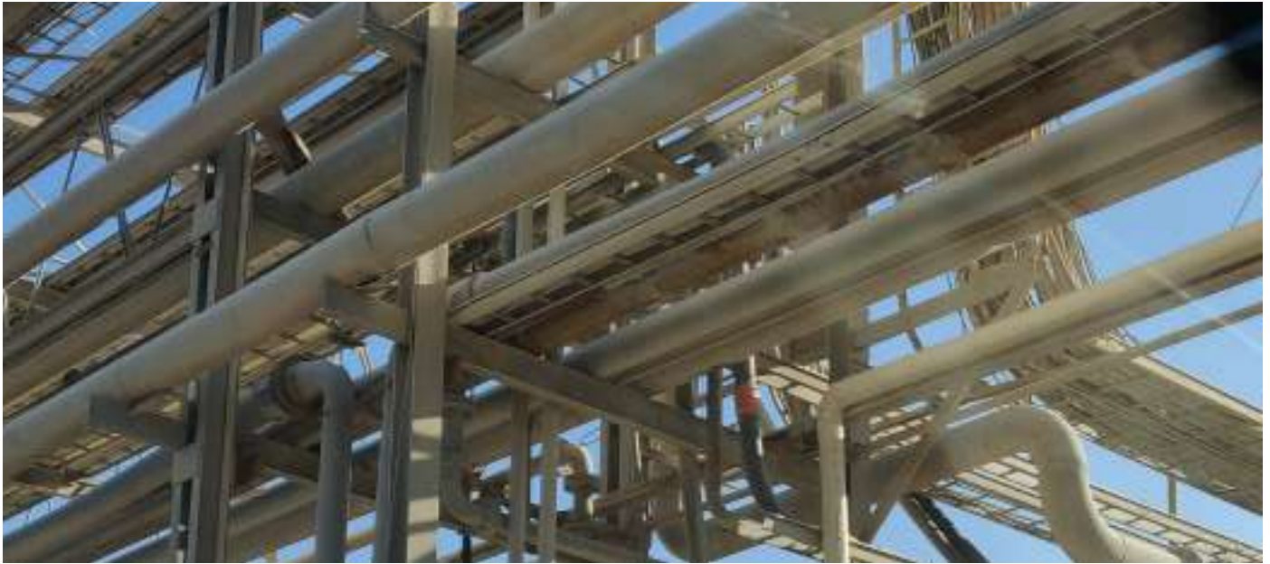
Tubería Pexgol para transporte de ácido fluorosilícico.
