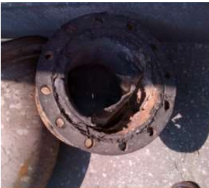
Tubería de acero engomada después de 6 meses de uso
