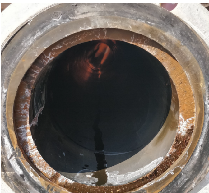
Tramo de prueba instalado en 2016, luego de dos años no se presentaron incrustaciones ni fugas.
